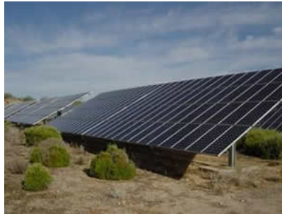
Cidead. Central fotovoltaica de la Puebla de Montalbán, Toledo ( CC BY-NC-SA )
